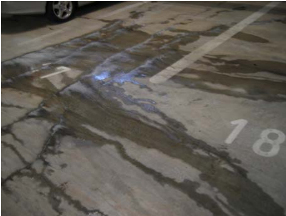
Abb. 2: Rinnstellen im Bereich der Bodenplatte
