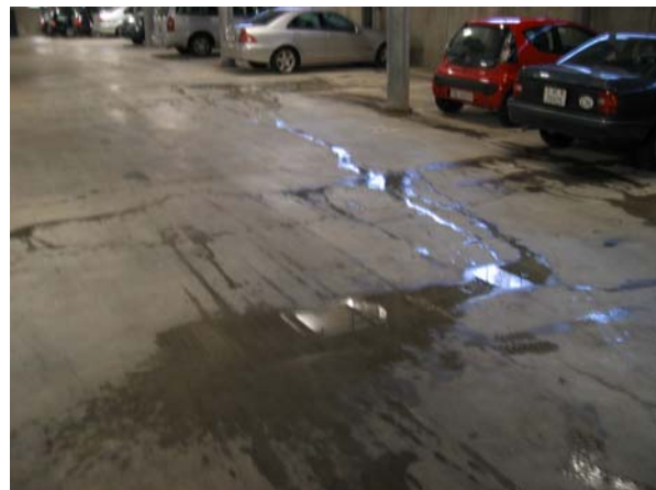
Abb. 3: Rinnstellen im Bereich der Bodenplatte
