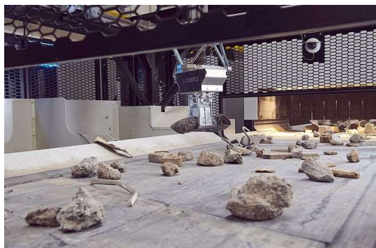
Sortieranlage EbiMIK von Eberhard (Eberhard Recycling AG)
